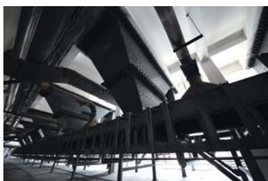
破碎车间采用布袋式除尘器除尘
